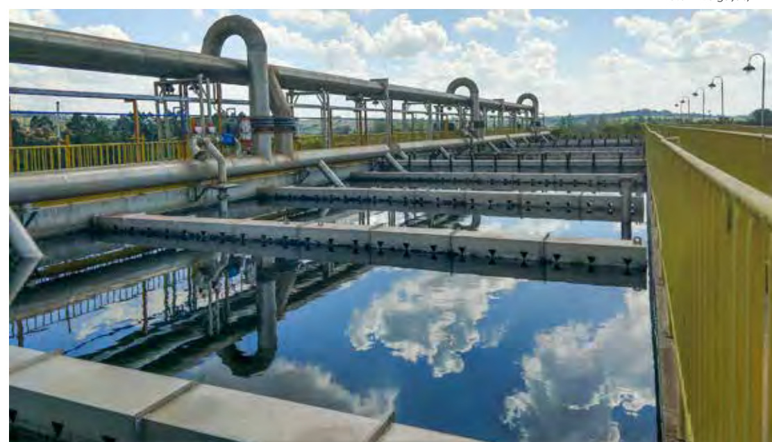
Estação de tratamento de esgoto no Jardim Novo em Rio Claro
