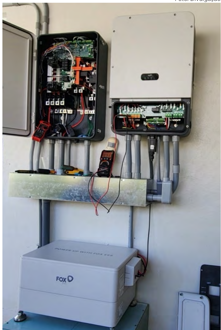
Instalação de um sistema de armazenamento ajuda em caso de apagão
