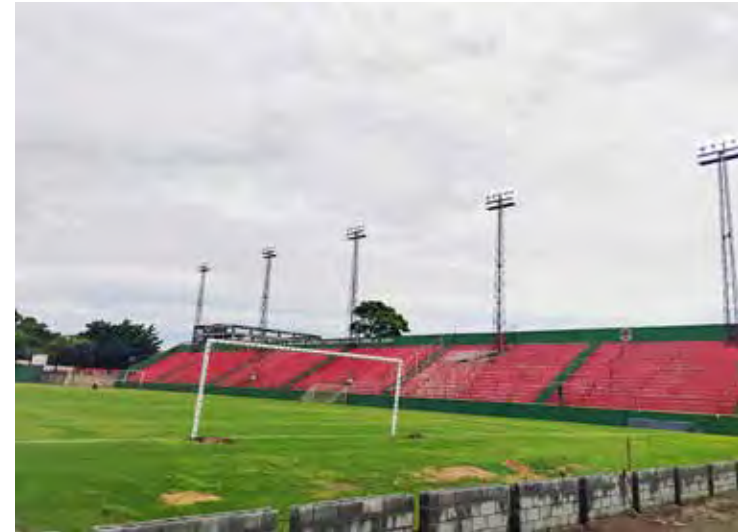
Sistema de iluminação já está completo e funcionando
