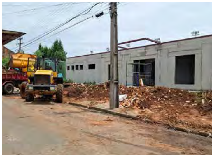
Construção da nova sede administrativa exigiu retirada de parte do muro de frente para a rua 3
