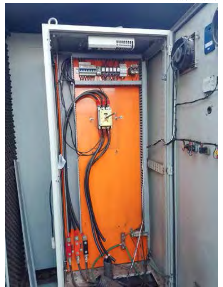
Equipamentos tiveram cabos e dispositivos retirados
