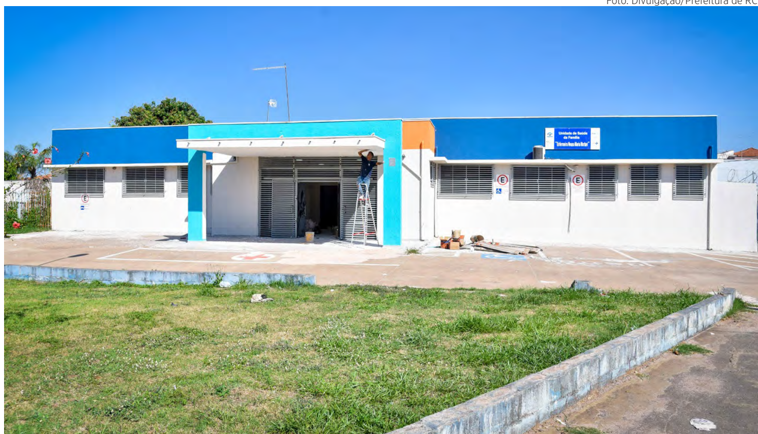
Fachada do prédio da unidade de saúde do Jardim Brasília que recebeu ampla reforma
