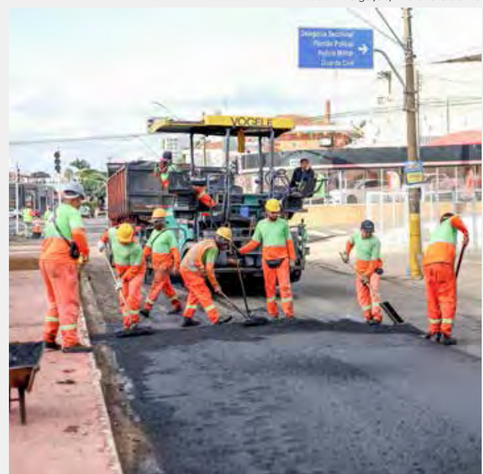
Antes do recapeamento foi usada técnica de fresamento para aumentar a aderência da massa asfáltica
