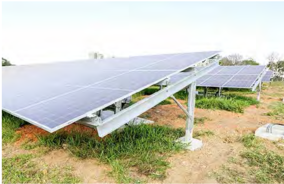
Usina fotovoltaica do Parque Ecológico de Águas Claras no Distrito Federal
