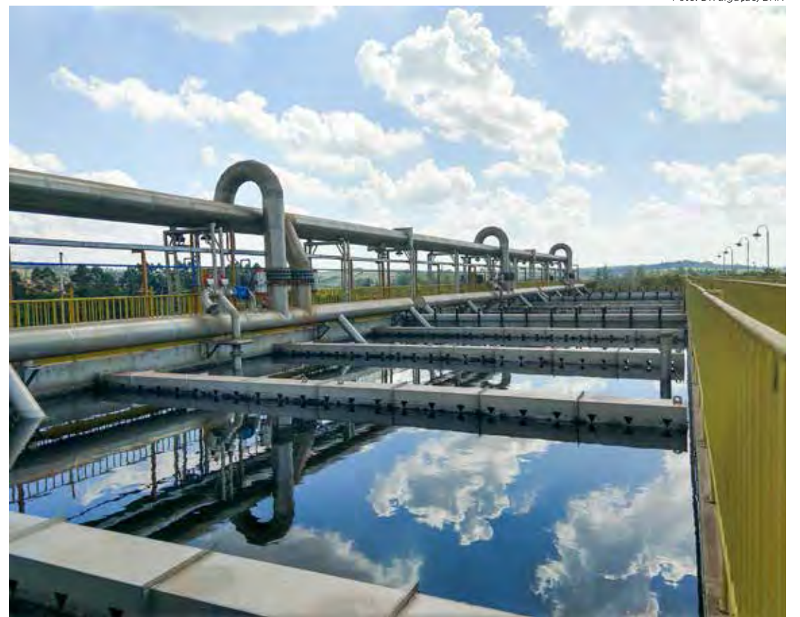
ETE Jardim Novo entrou em operação em 2017 ampliando o índice de tratamento de esgoto
