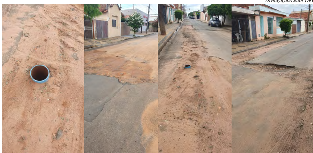
Buracos foram abertos em dezembro para reparo em rede de água e ainda não foram fechados
