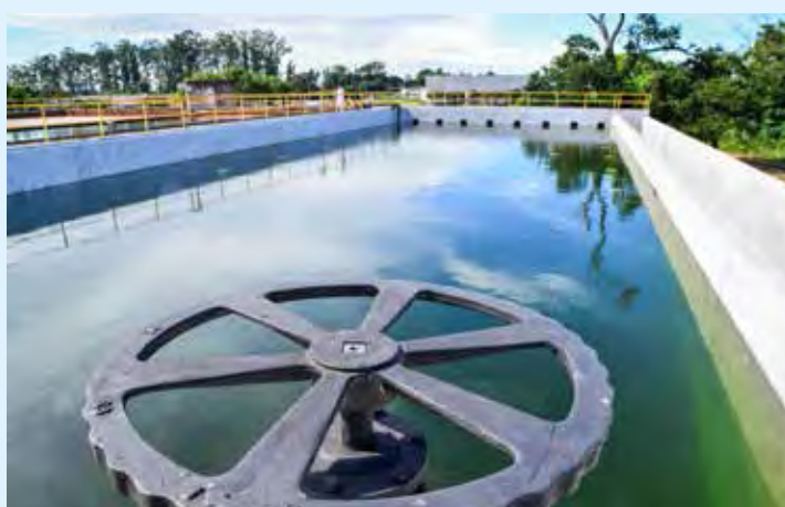
Localizada na estrada Rio Claro-Ajapi, a ETA 2 abastece 60% do município
