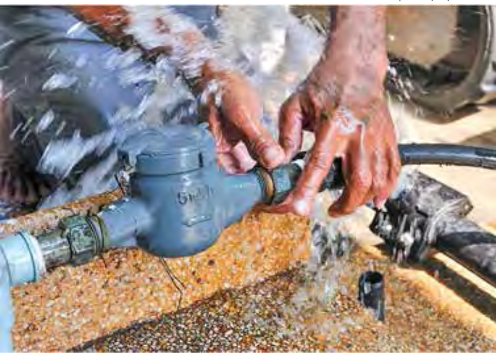
Vazamentos visíveis e não visíveis contribuem com as perdas de água tratada
