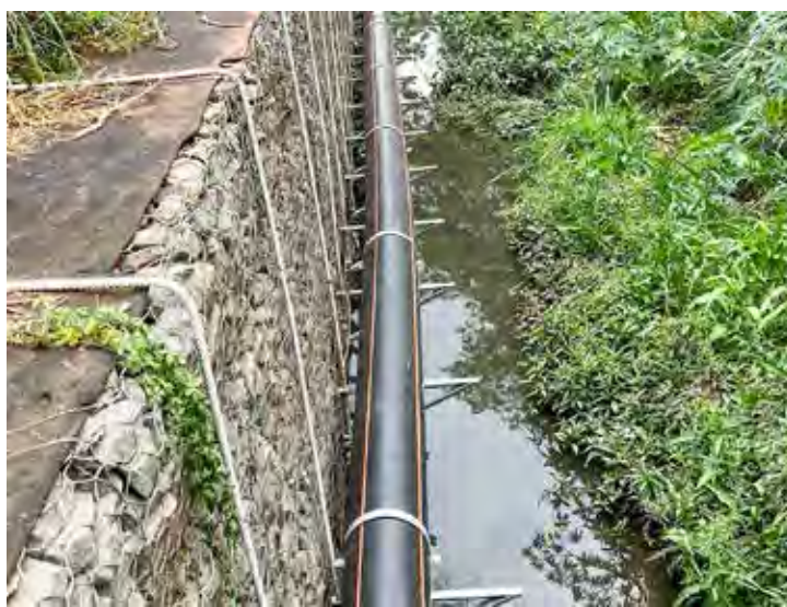
Com a finalização das obras a cidade passa a ter 100% de esgoto tratado
