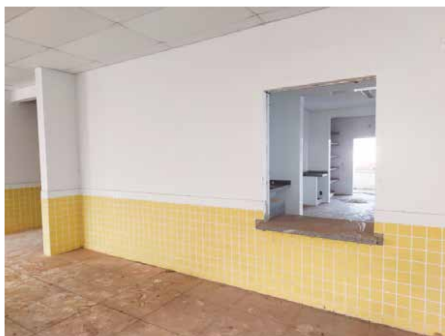
Obra paralisada da creche em construção no Jardim Residencial das Palmeiras
