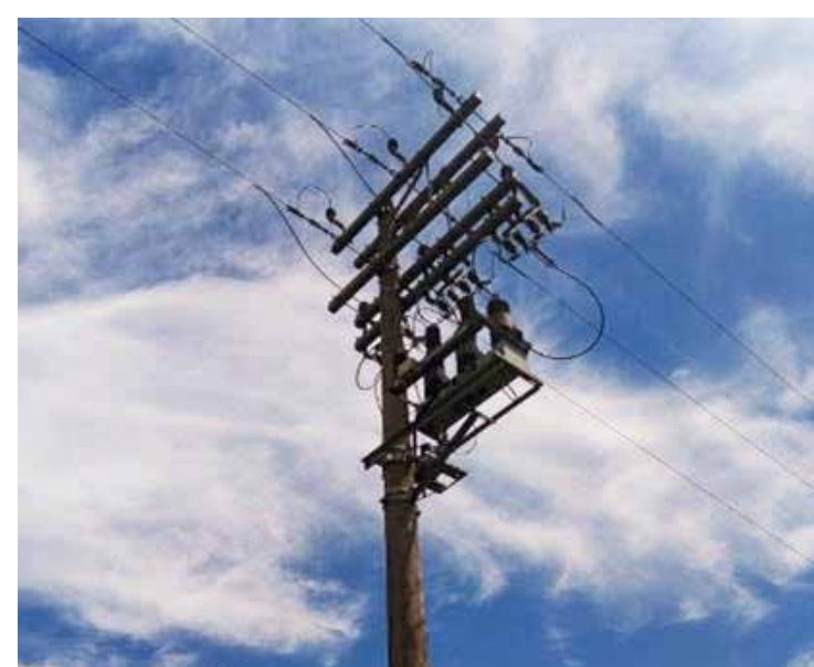
Religador auxilia na recomposição do sistema elétrico automaticamente, no menor tempo possível, em caso de interrupções
