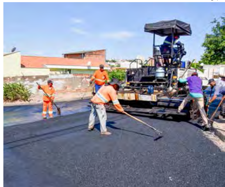
Trechos de ruas e avenidas do bairro Santa Maria receberam nesta terça-feira (8)
