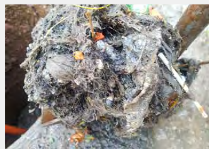
Os resíduos mais encontrados na rede de esgoto são restos de construção civil e descartes de banheiro
