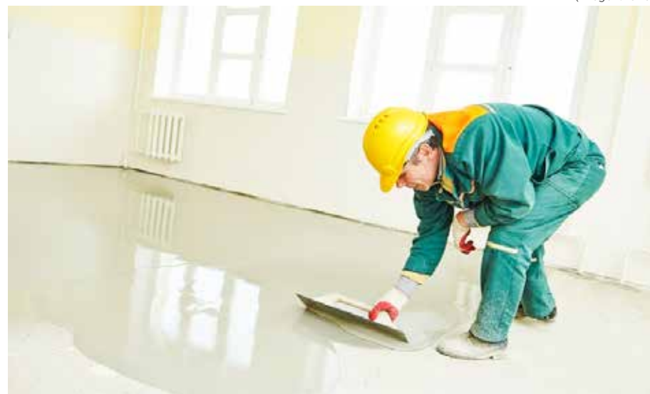
O rejunte é um material cremoso, que deve ser aplicado depois que o piso ou revestimento for colocado
