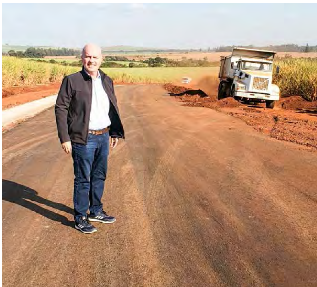
Quilici durante visita ao canteiro de obra de estrada vicinal em Santa Gertrudes
