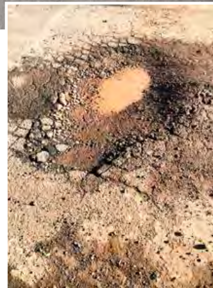
Em outro local a moradora enviou foto e relatou a situação do buraco no asfalto em frente a garagem da residência
