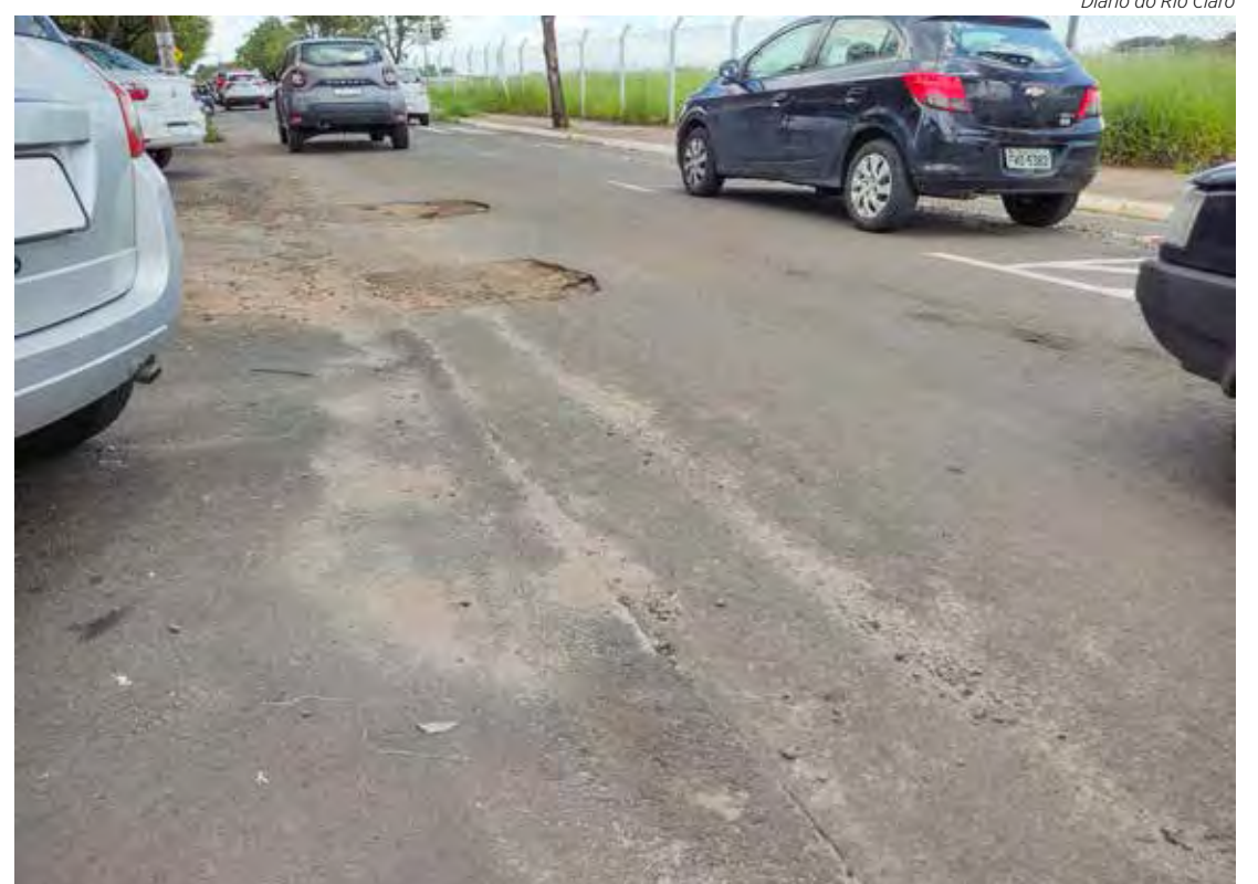
Na Rua João Polastri é possível constatar a impossibilidade de se transitar pelo trecho
